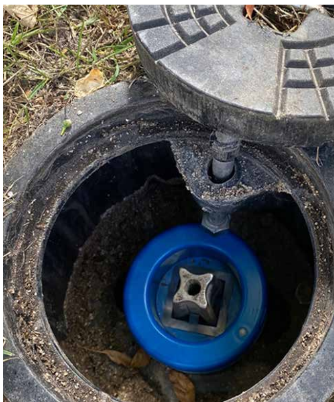
Capteur de position VIDI installé dans une bouche à clé
